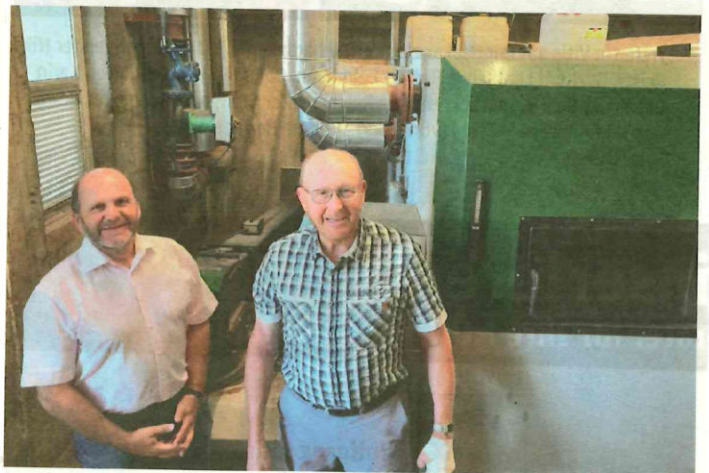
▲ Viele Jahre treue Dienste hat der Ofen im Heizraum der Fernwärme Langau geleistet, aber jetzt so Obmann Franz Reiss (links) und Vorstandsmitglied Karl Kühlmayer wird er durch einen neuen, effizienteren ersetzt. Foto: Rupert Kornell
